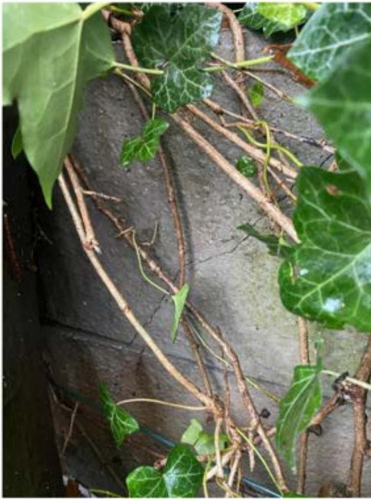
Scheur in keerwand
