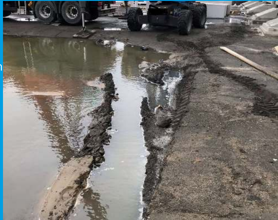
Beschadigd talud door belasting met zwaar materieel
