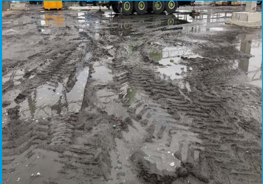
Beschadigd oppervlak door transportbewegingen
