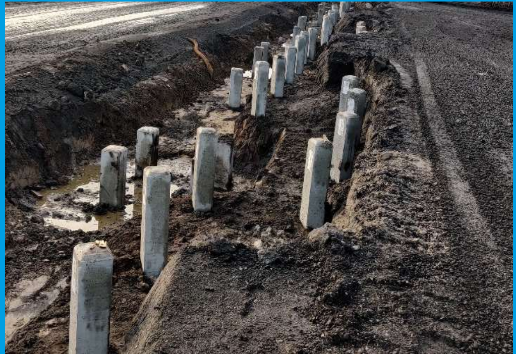
Beschadigd immobilisaat door graaf -en hei werkzaamheden
