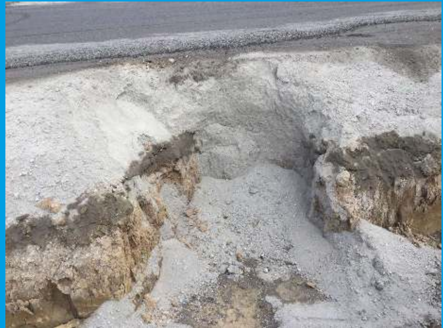
Talud is niet afdoende verdicht en vergraven
